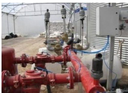
شکل ۲۸- تزریق کود با استفاده از پمپ دیافراگمی با استفاده از نیروی مکش سیستم آبیاری
